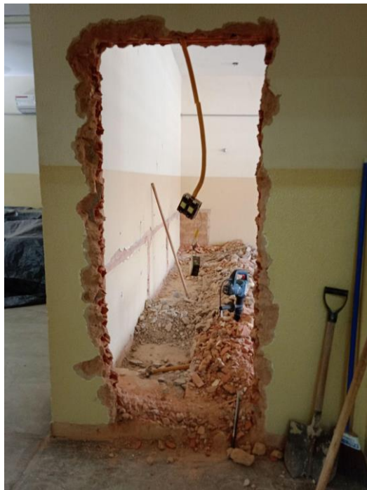
Registro Fotográfico nº 05 – Corte em alvenaria para instalação da porta da sala 206-B
