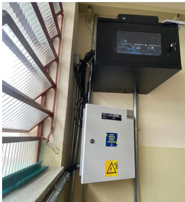
Registro Fotográfico nº 27 – Quadro elétrico e rack da sala 206-A (LICC 1)
