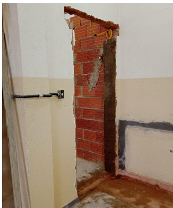
Registro Fotográfico nº 12 – Acabamento para instalação do batente da porta da sala 206-B
