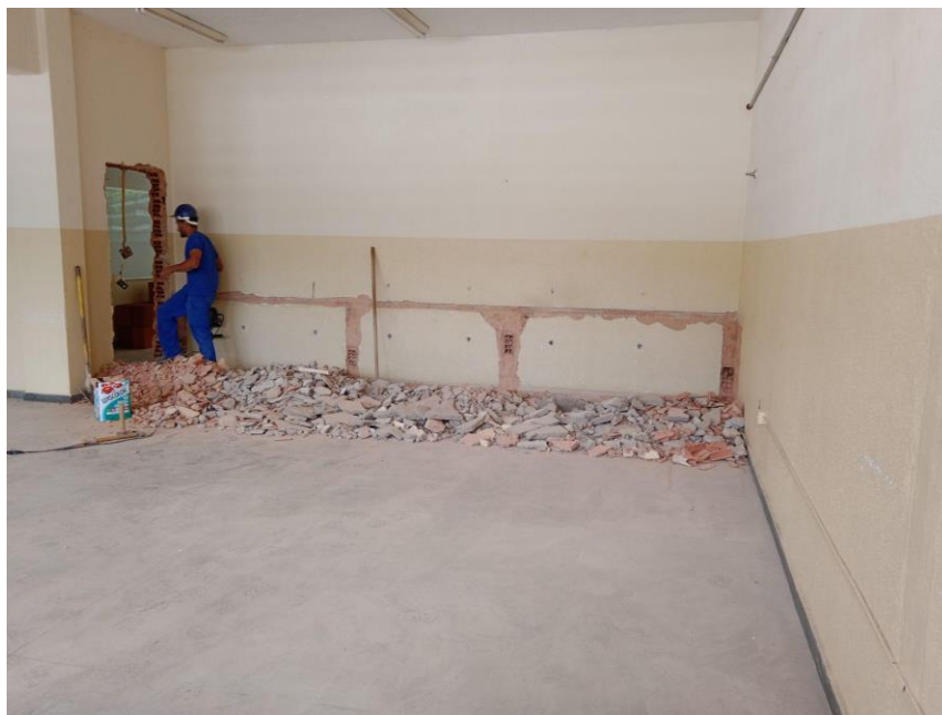
Registro Fotográfico nº 01 – Demolição de bancada na antiga sala 206 (Laboratório de Hidráulica)
