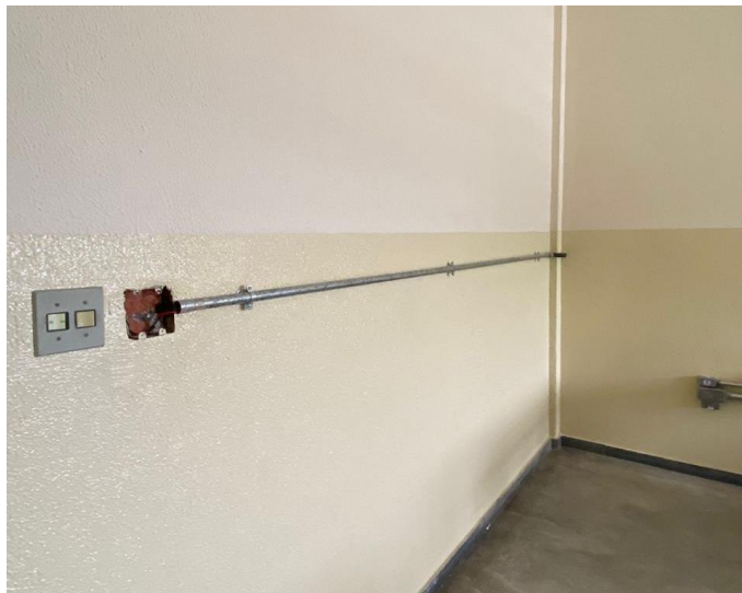
Registro Fotográfico nº 28 – Separação do comando de iluminação das salas 206-A e 206-B
