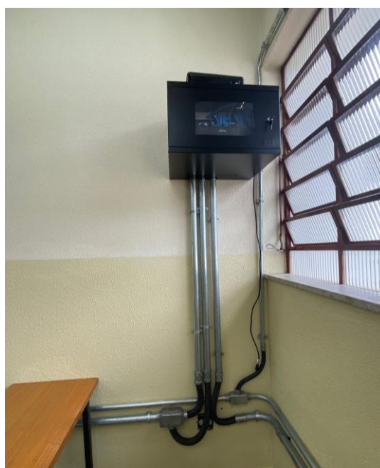
Registro Fotográfico nº 33 – Rack da sala 206-B (LICC 2)
