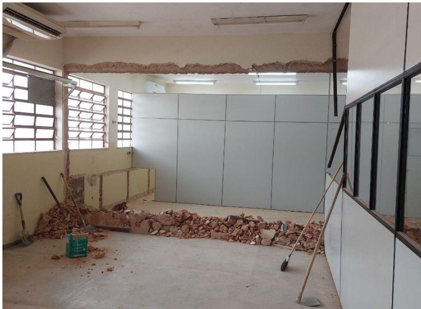
Registro Fotográfico nº 07 – Demolição da parede de alvenaria que divide as salas 201 (antigo LICC) e 202-D (antigo Laboratório de Transportes)
