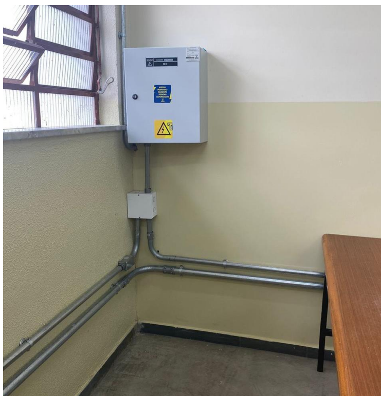
Registro Fotográfico nº 31 – Quadro elétrico da sala 206-B (LICC 2)
