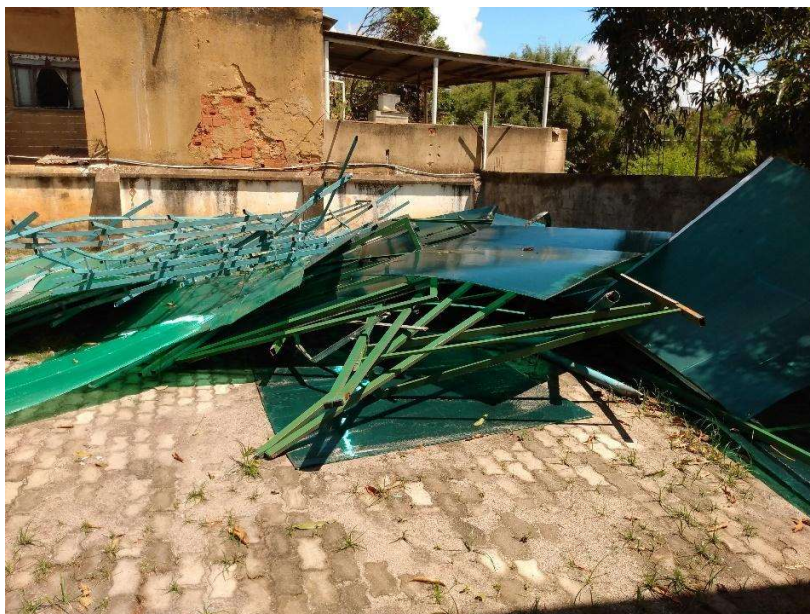
Foto 10 – Cobertura de policarbonato destruídas
